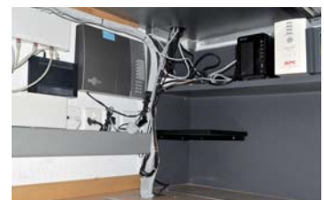
Serverfreie Hardwareinstallation für acht Arbeitsstationen nach Konzept AR&IT.
