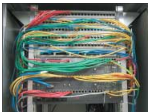
Verkabelung eines Switch-Rangierfeldes im 19 Zoll-Schrank.
